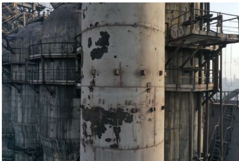
Рис. 1. Дефекты лакокрасочного покрытия
